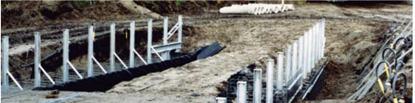
Januari 2005 schanskorf-constructie dam A en interne HE 120A profielen t.b.v. de hekwerk-stijlen
