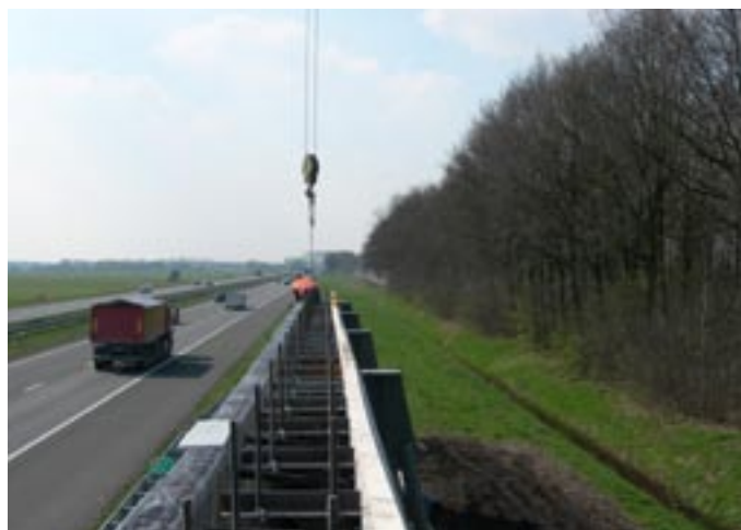
April 2008: inhangen van de elektreet filters
