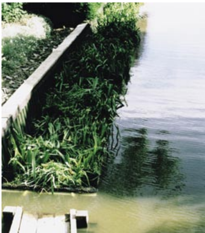
De fauna-passage sluit aan op een looprichel onder een brug.
